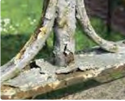
a) Demir yüzeyinde kütle kaybı
