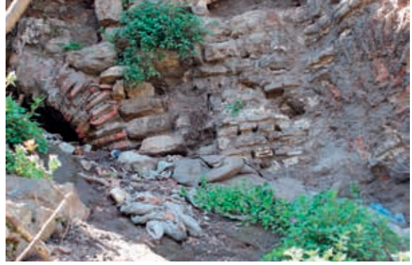
Şekil 11 Apsis cephesinin güney kesiminde, molozlar arasında kalan kemerli açıklık (M. Sav, 2011)
