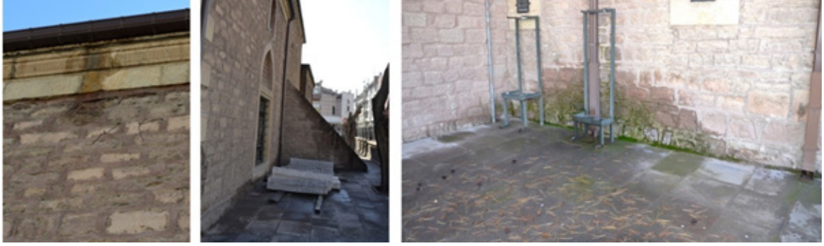
Fotoğraf 18-19-20: Yağmur sularının yapıya etkileri
