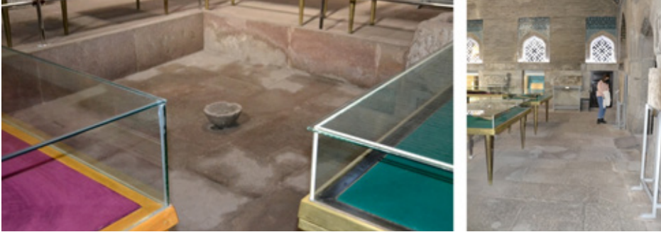
Fotoğraf 11,12: Havuzda ve avlu zemininde gözlenen bozulmalar
