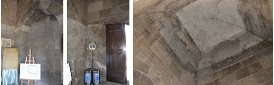
Fotoğraf 8,9,10: Giriş bölümünde gözlenen bozulmalar
