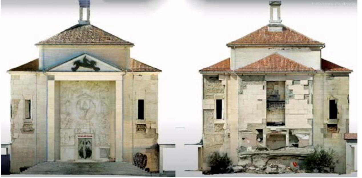
Şekil 6. Santa Maria Assunta Kilisesi deprem sonrası fotogrametrik belgelemede ön ve arka cephelerin hasar durumu.
