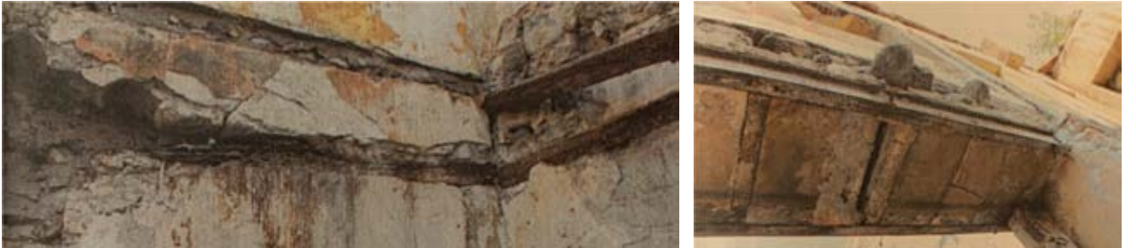
Şekil 24. Duvar içindeki taşıyıcılığını yitirmiş ahşap hatıllar, bozulmuş kesme taş ve korozyona uğramış metal elemanlar (Samsun Büyükşehir Belediyesi KUDEB tarafından hazırlanan 25.08.2017 tarihli rapor).
