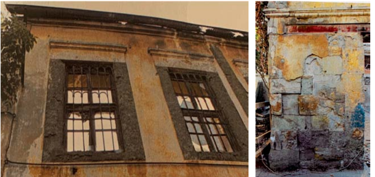
Şekil 25. Beden duvarındaki kesme taşların taşıyıcılığını yitirdiğini, kabuklaşıp döküldüğünü gösteren fotoğraflar (Samsun Büyükşehir Belediyesi KUDEB tarafından hazırlanan 25.08.2017 tarihli rapor).
