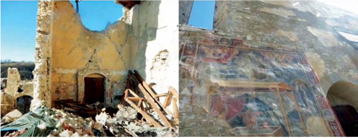
Şekil 4. San Francesco Kilisesi, 2016 depremi ve artçı depremler sonrası.
